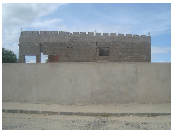
Figura 02 – EE-01 vista da Rua Benjamin Barroso_1 – Muro
