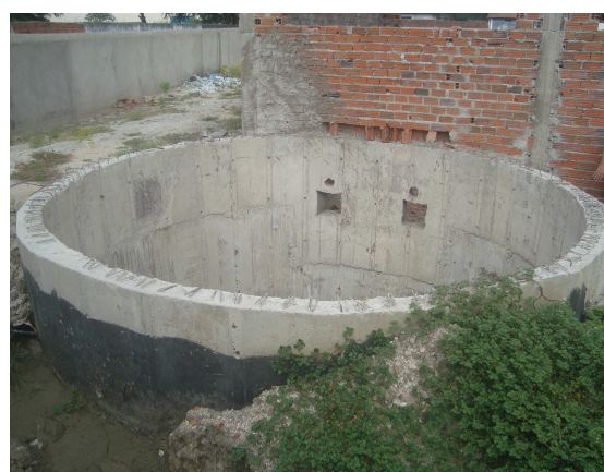
Figura 05 – EE-01 Poço de Sucção
