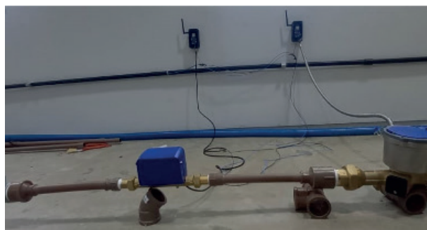
Fig.1- Hidrometros DN20 e DN40
