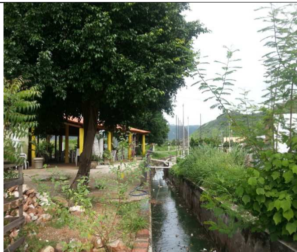
FOTO 03- DRENAGEM A CÉU ABERTO COM ESGOTO CLANDESTINO
