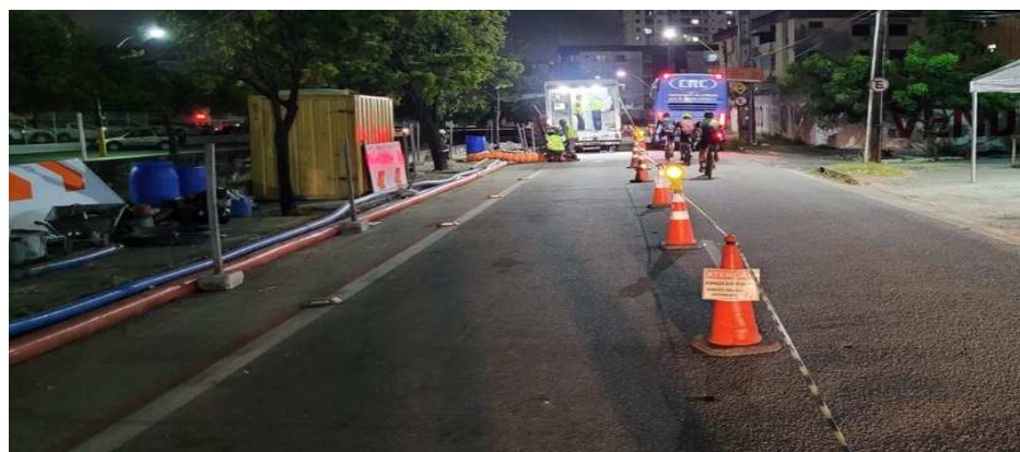
Figura 31 - Dispositivo luminoso intermitente com acendimento sequencial
