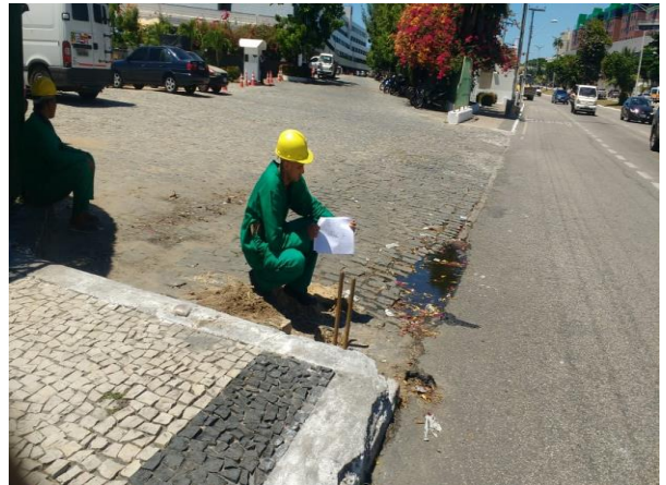
FOTO 04 Detalhe do local onde foi realizado o furo ST-07 do plano EPC.
