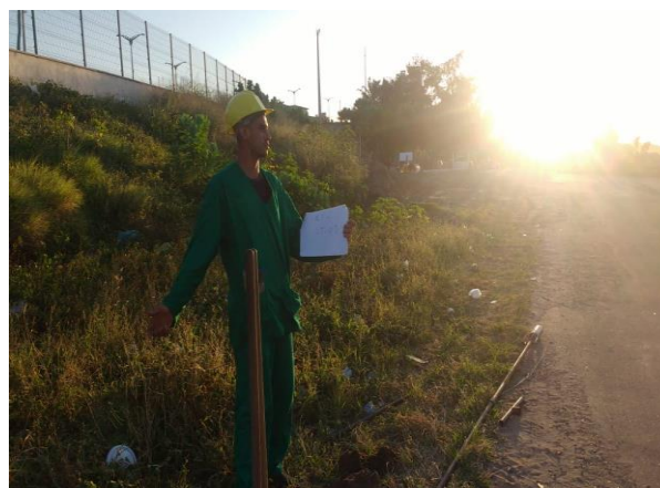
FOTO 08: Detalhe do local onde foi realizado o furo ST-09 do plano EPC.
