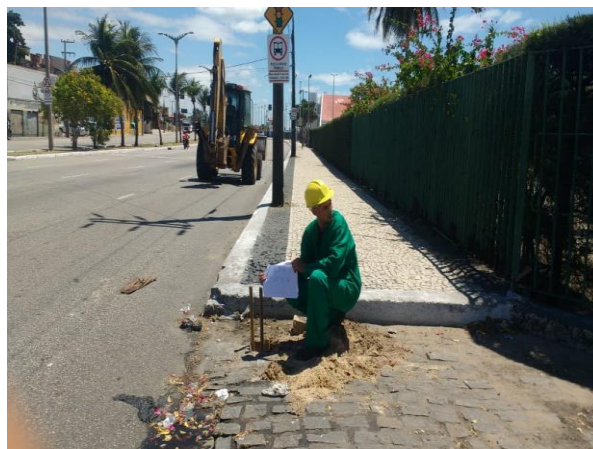
FOTO 05: Detalhe do local onde foi realizado o furo ST-07 do plano EPC.
