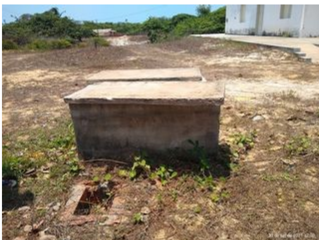
Foto 11: Poço Tubular na região da Formosa
