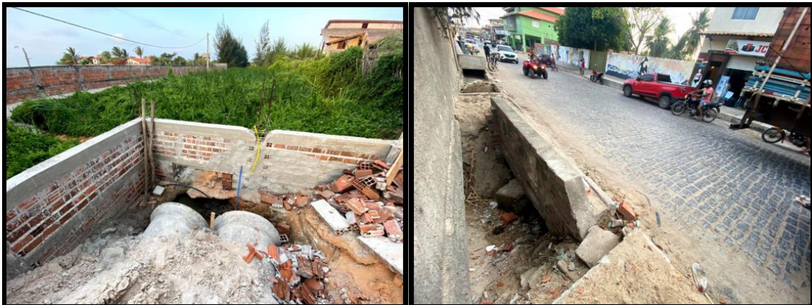
Figura 2 - Exemplo de ocupação desordenada e comprometimento dos equipamentos de drenagem na localidade do Preá.
