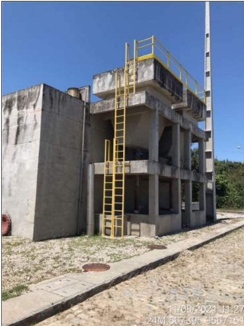
Foto 4.5. REATOR UASB + FSA + DL, ETE PDD - Aquiraz
